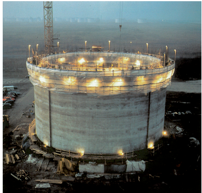
Bild 5. Kryogener Etylentank Wilhelmshaven
